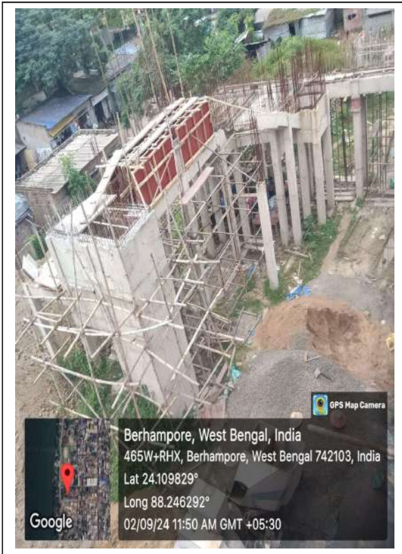
BEHARAMPORE STP SITE
