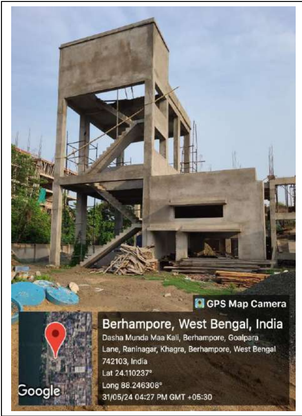
BEHARAMPORE STP SITE
